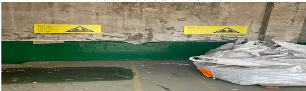
危险废物贮存场内部导流沟和收集井
