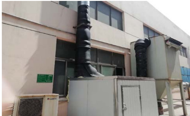
包覆工段袋式除尘器和标志牌
