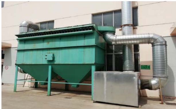
焊接工段袋式除尘器和标志牌
