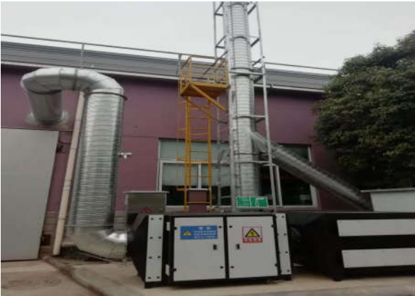
车间一危废暂存库设置废气收集导出净化处理装置
