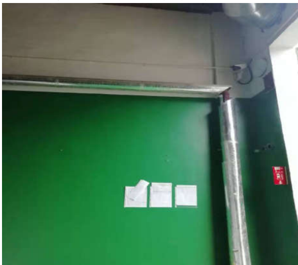
车间一危废暂存库内视频监控
