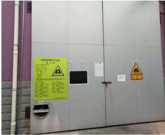
车间一危废暂存库外标识和观察窗
