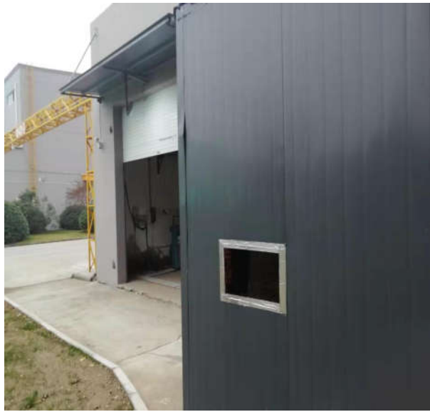
厂区北侧危废暂存外部视频和观察窗
