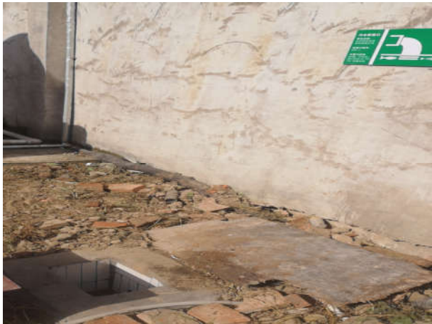
污水排放口及标志牌
