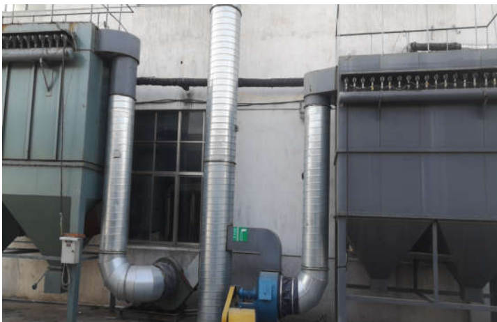
车间四区和车间三区的布袋除尘器及排气筒
