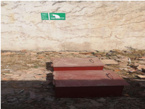
地埋式一体化生活污水处理装置
