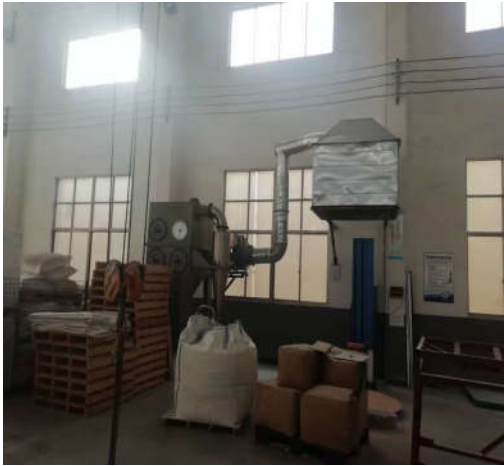
包装工段布袋除尘器
