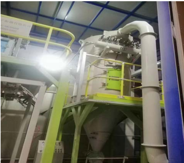
DA011 排气筒脉冲袋式除尘器
