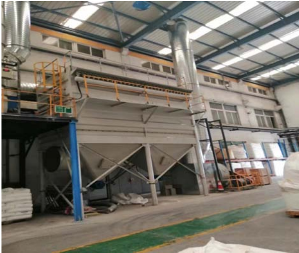
DA012#排气筒两级袋式除尘器
