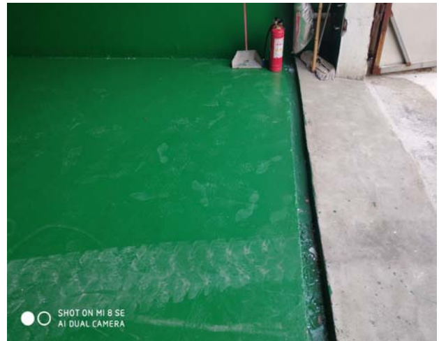
车间一危险废物贮存场导流沟
